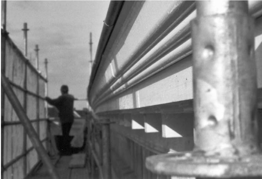
Afb. 3: Op deze foto is duidelijk de kromming in de dakgoot waarneembaar.
