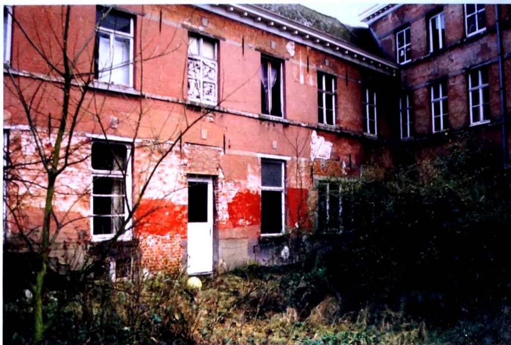
In 2000 ligt de binnentuin er verwilderd bij en bieden de buitengevels een verwaarloosde indruk. (Ver. G. Coppens)
