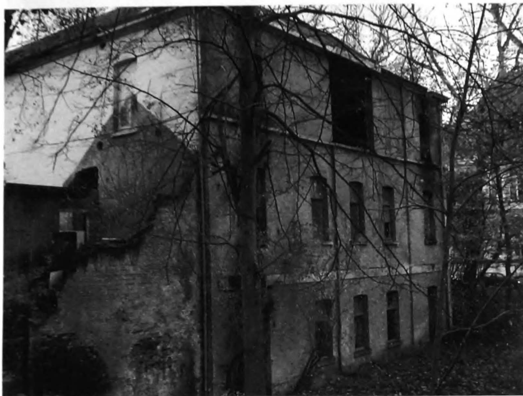
Zicht op een zijgevel van het koetshuis en de paardenstallen. De gebouwen zijn erg vervallen, terwijl een achtervleugel grotendeels is weggebroken. (2004) (Foto J. De Ro)
