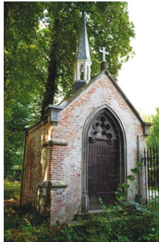
De gerestaureerde kapel langs de kasteeldreef van de baronie Boelare. (Foto J. De Ro)
