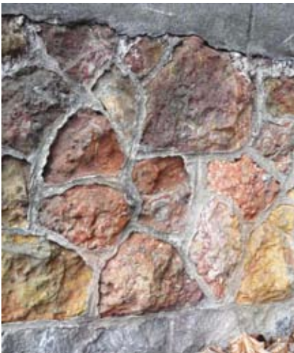
Grandglise zandstenen in de plint van het voormalige restaurant Grill
